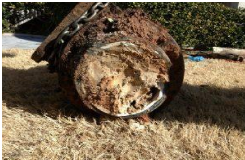
Figure 4 : Canalisation bouchée à cause des huiles de friture
